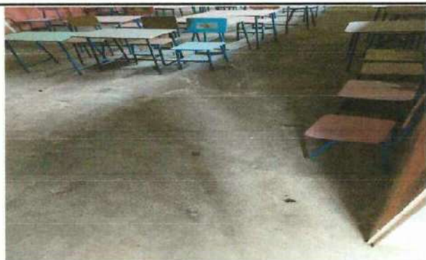
Foto 3: Se observa que es necesario colocarle piso cerámico.
