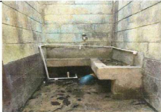
Foto 4: Se observa que es necesario colocar un mingitorio.
