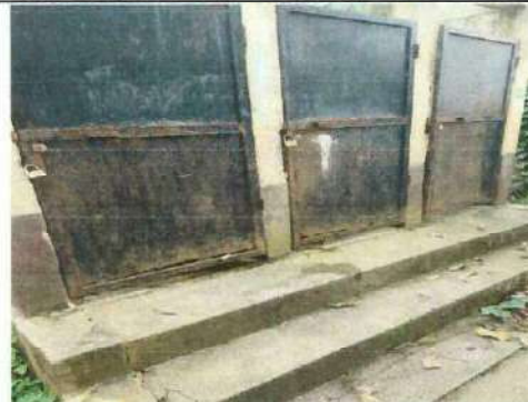
Foto 2: Se observa que las puertas ya están deterioradas.
