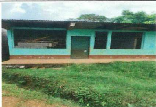
Foto 1: Se observa que es necesario colocar balcones.
